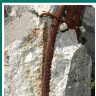
Korozja stalowego zbrojenia w betonie
