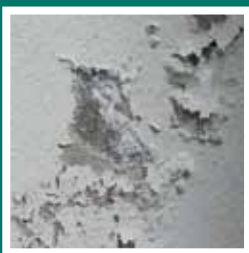
Wykwity solne na powierzchni powłoki malarskiej
