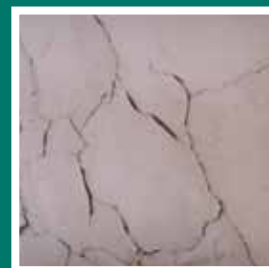
Wnikająca w pęknięcia woda powoduje dalsze niszczenie podłoża i powłok malarskich
