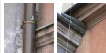
Efekt działania wilgoci w budynku z uszkodzonymi obróbkami blacharskimi
