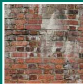
Krystalizacja soli mineralnych na powierzchni ceglanego muru
