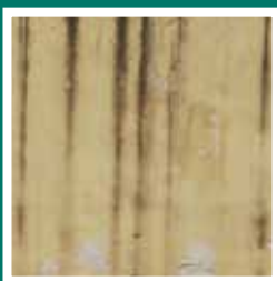
Trwałe zabrudzenie powłoki malarskiej (sadza, pyły)
